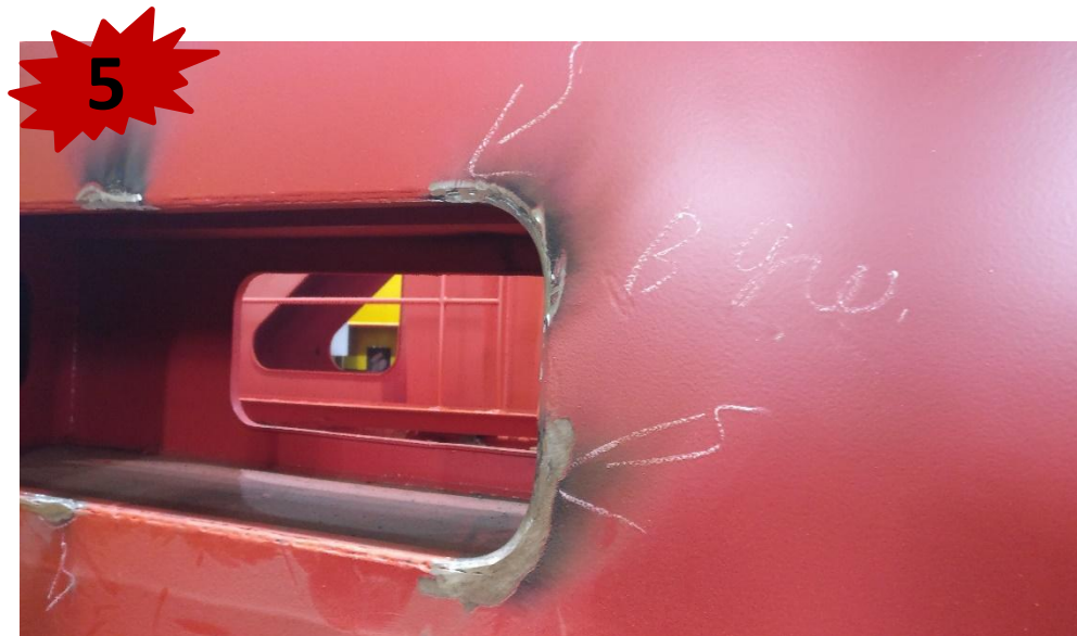
КПМ. Некачественная сварка обнаружена уже в окрашенном кране при сдаче ОТК
